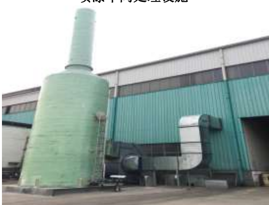
焊接烟气喷淋塔
