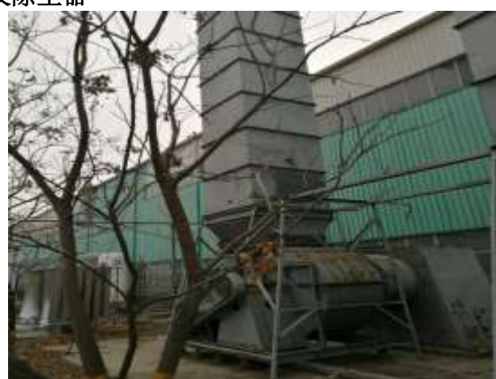
喷漆车间处理设施
